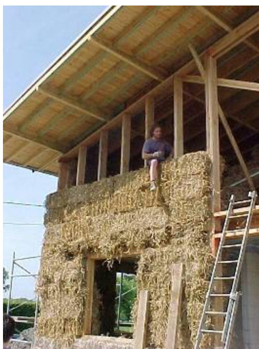
Figuur 10.21 Ter hoogte van de verdiepingvloer kan er geen volledige strobaal geplaatst worden, en wordt er los stro gebruikt.
