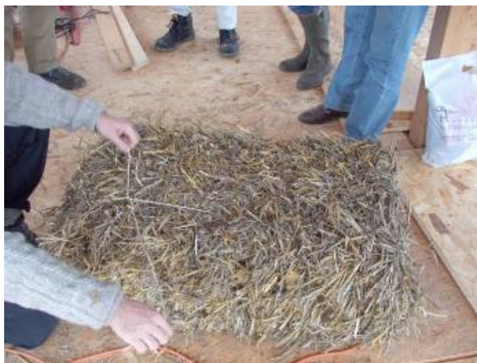
Figuur 4.3 Het nieuwe touw wordt vastgebonden en er wordt een kleinere strobaal bekomen
