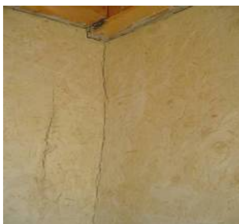
Figuur 10.30 Barsten in pleisterwerk
