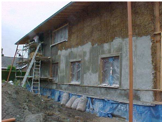
foto Henk Van Aelst Na het plaatsen van de strobale wordt het geheel bepleisterd.
